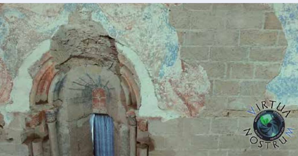
Figura 4. Captura realizada con RPAS para la identificación de patologías en el interior de la iglesia de Santiago (Sigüenza, Guadalajara).
